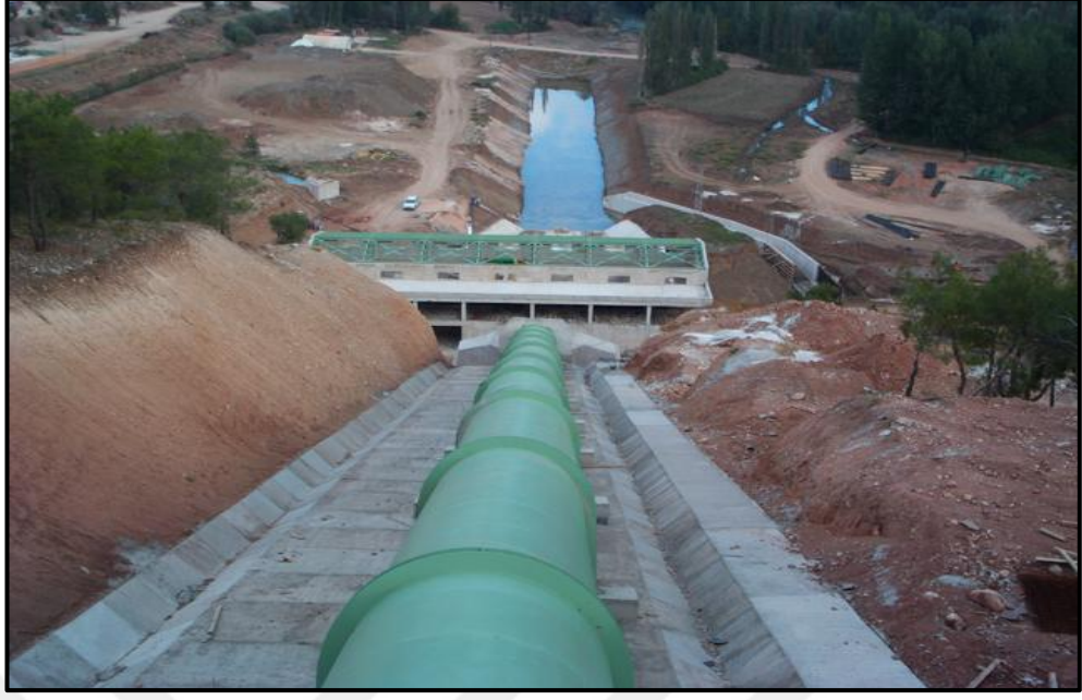
Şekil 1.5. Hidroelektrik Santral Cebri Boru (Kazankaya Regülatörü ve HES) (“Ygm”, 2019)
