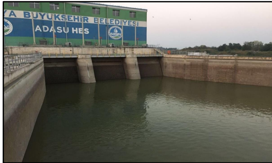
Şekil 1.3. Hidroelektrik santral su alma yapısı (Adasu Regülatörü ve HES) (“Saski”, 2019)
