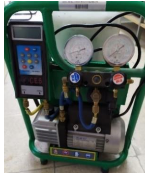
Şekil 3.7. Soğutucu akışkan şarj istasyonu.
